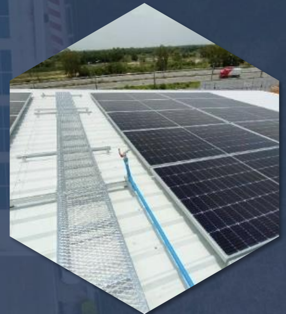
ระบบน้ำล้างแผง
